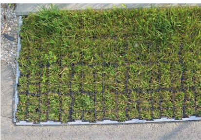
Der Randstein stellt den Abschluss zwischen Versickerungssystem und Straße her.
