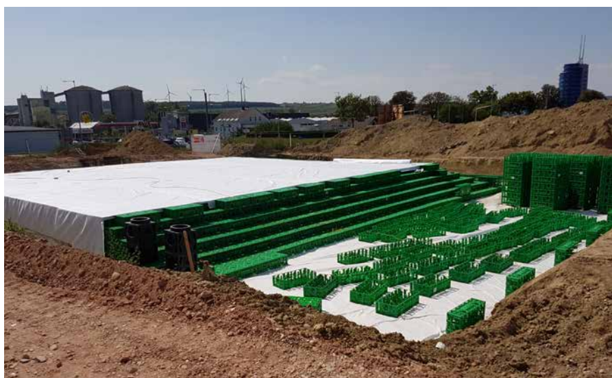
Mehrere Schächte ermöglichen die Inspektion des Rückhaltekörpers.
