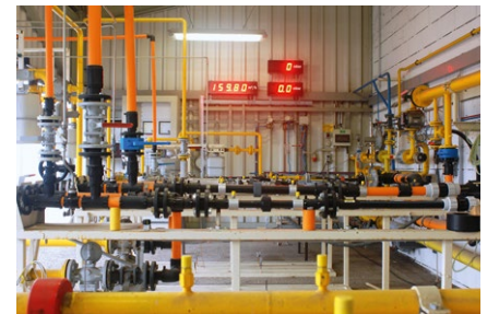
Banco de pruebas de gas natural
