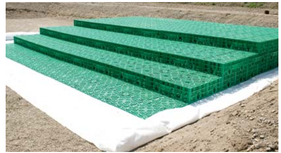
Teil der Versickerungsanlage für Dienstleistungszentrum Kapfenberg
